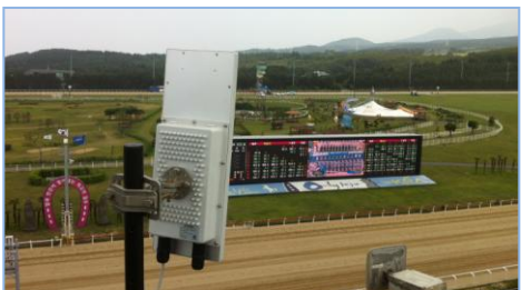
제주경마공원 방송실 옥상에 설치된 RFLINK-600S 장비
